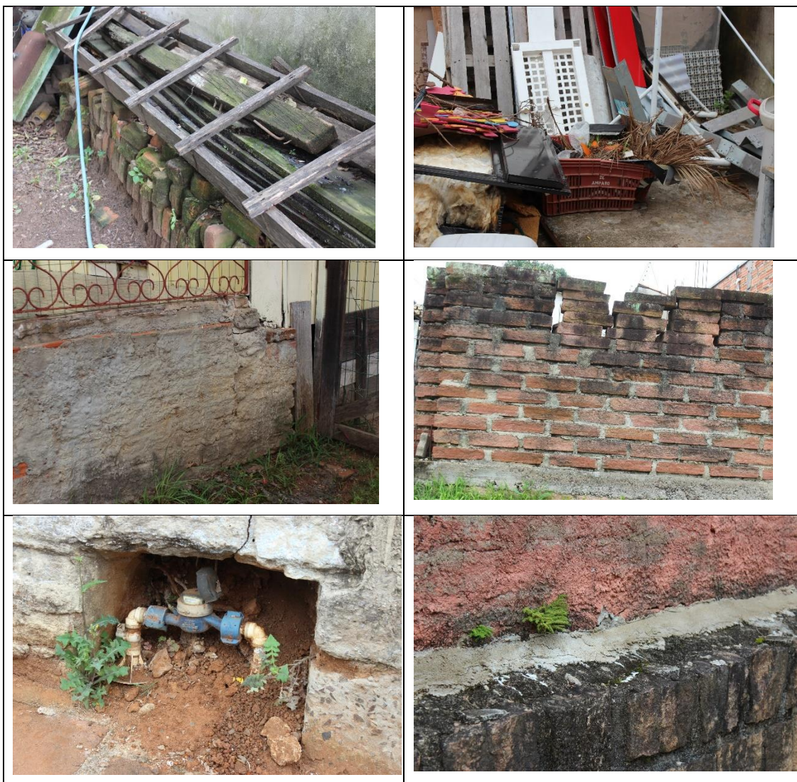
Figura 24 - Depósitos e disposições de materiais de construção (tijolos, telhas), madeiras em pátios internos, restos de poda, folhas junto a motor de portão eletrônico, além de muros e paredes sem devido reboco e pintura
