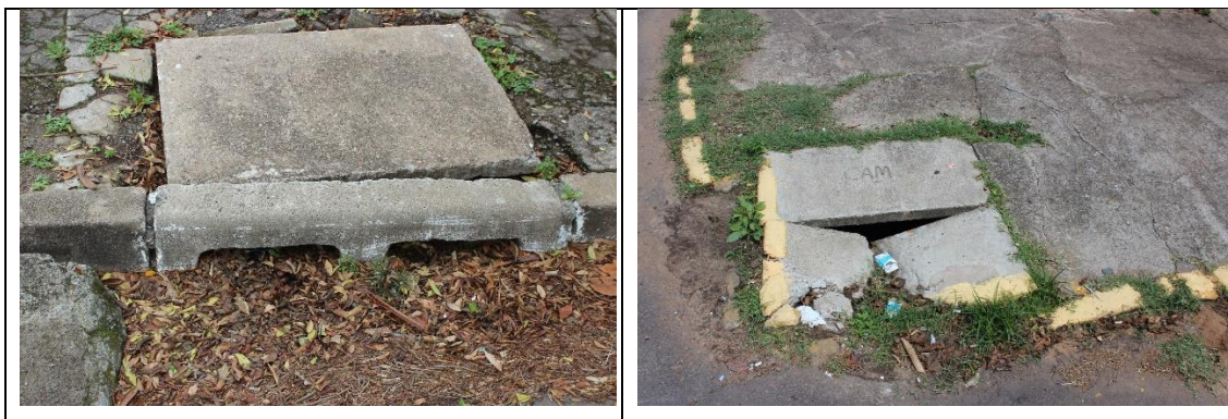
Figura 20 - Infraestruturas urbanas danificadas que precisam de reparos e limpeza semanal
