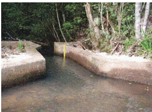
Figura 29. Calha Parshall modificada, com a localização da régua de leitura da altura da água. Fonte: S. Municipal de Saúde de Caxias do Sul, RS (2005).
