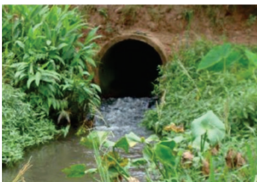
Figura 20. Tubulação de concreto sob ponte que atravessa o riacho. Fonte: Luciane de Armas. Emater/Fazenda Vilanova-RS
