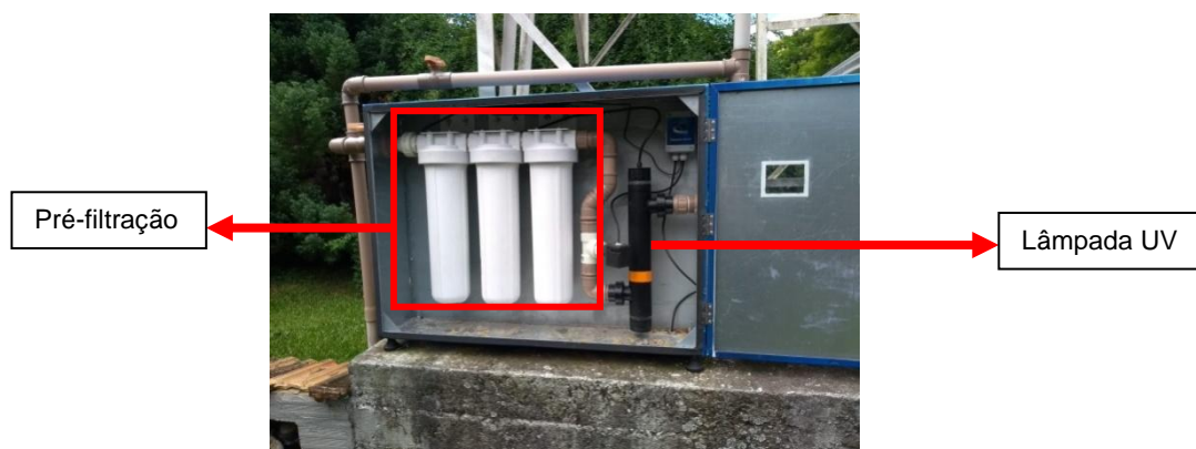
Figura 3 – Sistema de tratamento ultravioleta
