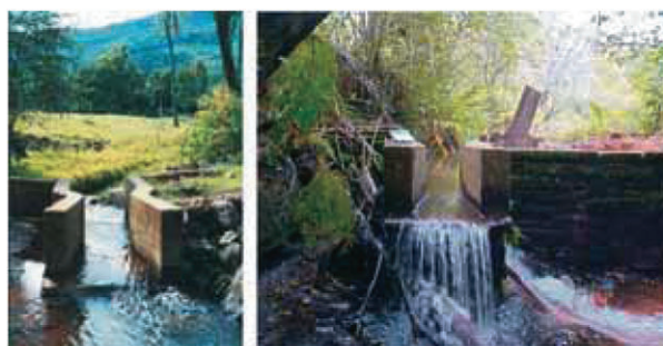
Figuras 2 e 3 - Medidor de Vazão
