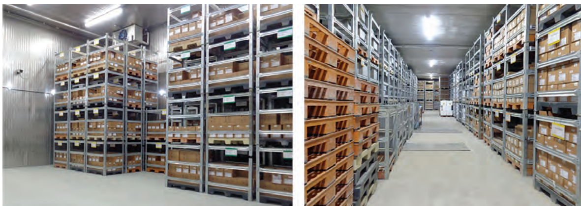
Figura 27 Câmara fria positiva (visão interna)
