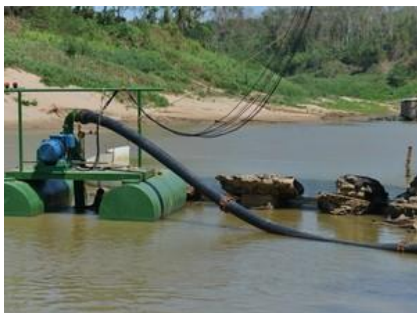
Nova bomba flutuante só deve entrar em operação caso Rio Acre atinja 1,25 metro (Foto: Alexandre Noronha/Asscom Depasa)
